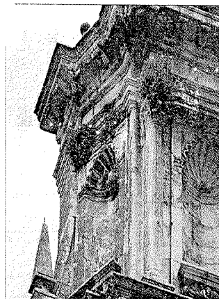
La maleza está vaciando toda la fachada del templo y dañando la piedra. / DB
